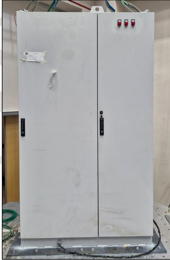
Şekil 1. Sismik Test A.G. Elektrik Panosu (Model No: Test Panosu PRJ26)
